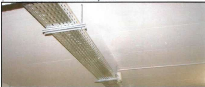
Kanalina metalike per magjistralet e linjave elektrike
