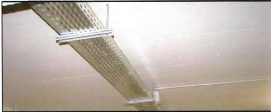
Kanalina metalike per magjistralet e linjave elektrike
